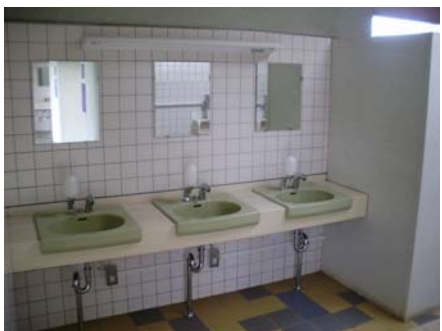
自動水栓化した手洗い
