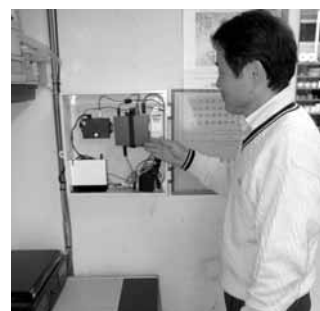
明和中学校の放送室に設置された緊急地震速報の受信装置
